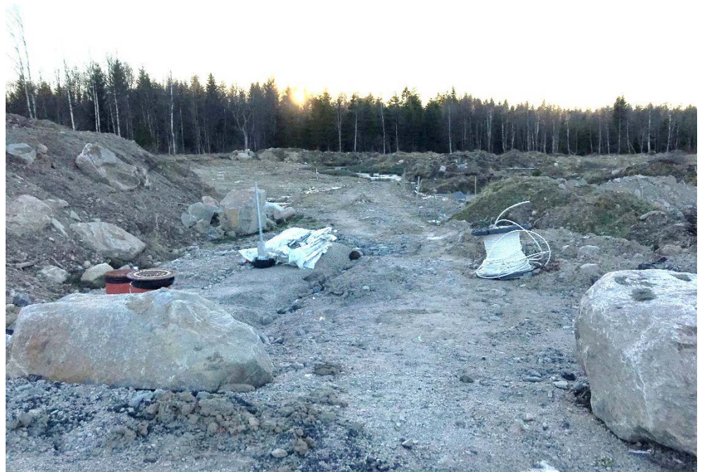
Figur 7. Vy mot väst över den södra delen av området; översta marklagret är redan schaktat och har lagts på hög.
